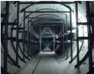
台電安南~府城段地下電纜統包工程 隧道
